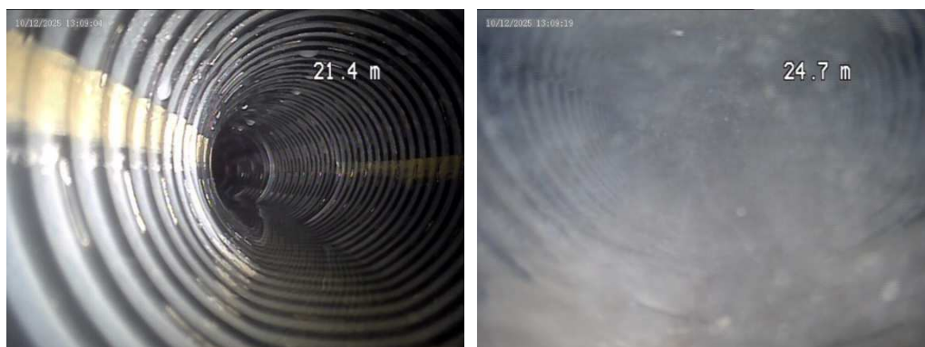
Drain 11 : Trace de montée en charge – retenue d'eau importante.
