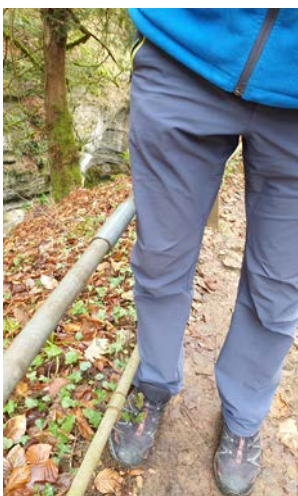
Image 2 : Hauteur insuffisante du garde-corps
