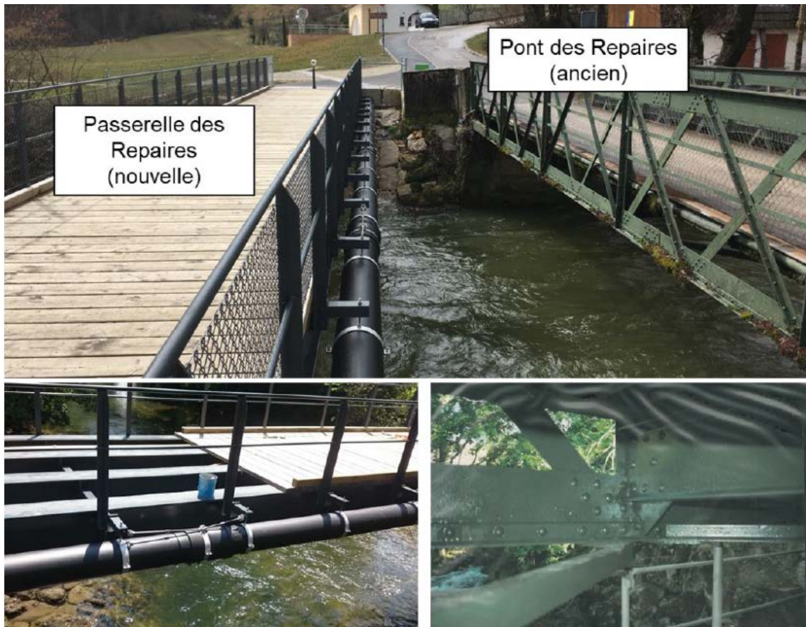
revêtements inférieurs des ouvrages aux Repaires, favorables à la formation d'embâcles © Stucky
