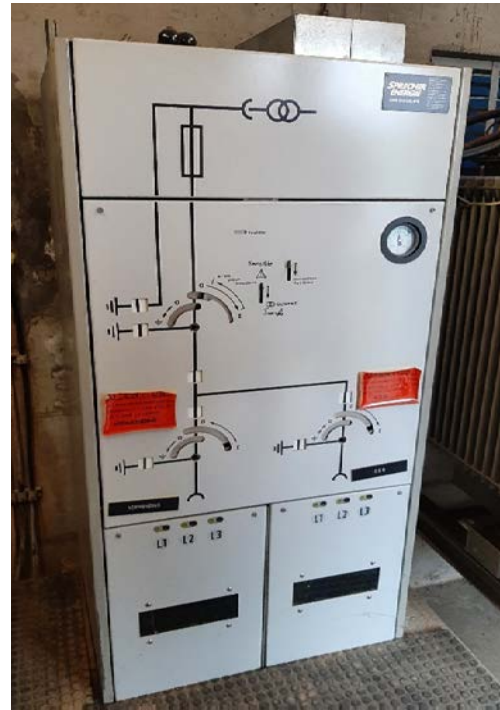
Figure 4 : Appareillage moyenne tension « Buchilles »
