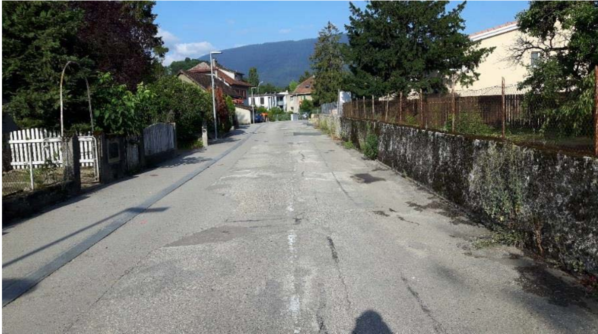
Illustration N°1 déformation de chaussée
