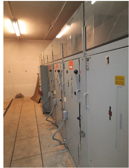
Figure 4 : Appareillage moyenne tension « Collège »
