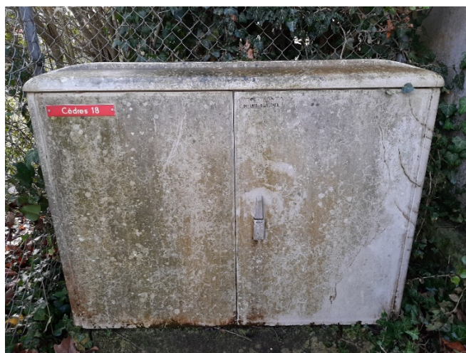
Figure 2 : Exemple d'armoire nécessitant le remplacement complet pour répondre aux normes
