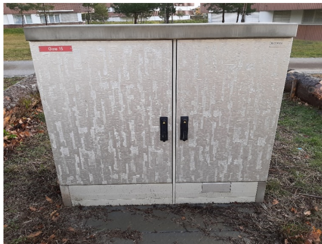
Figure 1 : Exemple d'armoire neuve avec compartiments BT et EP séparés
