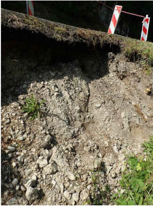
Figure 3: Niche d'arrachement dans le talus
