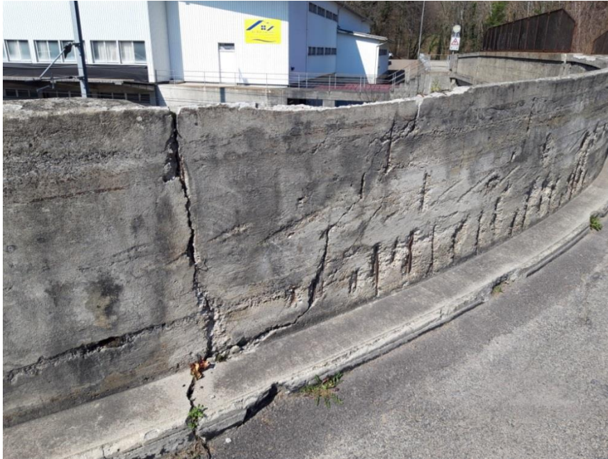
Figure 3 : Eclats de béton avec armatures apparentes et corrodées, étanchéité défectueuse
