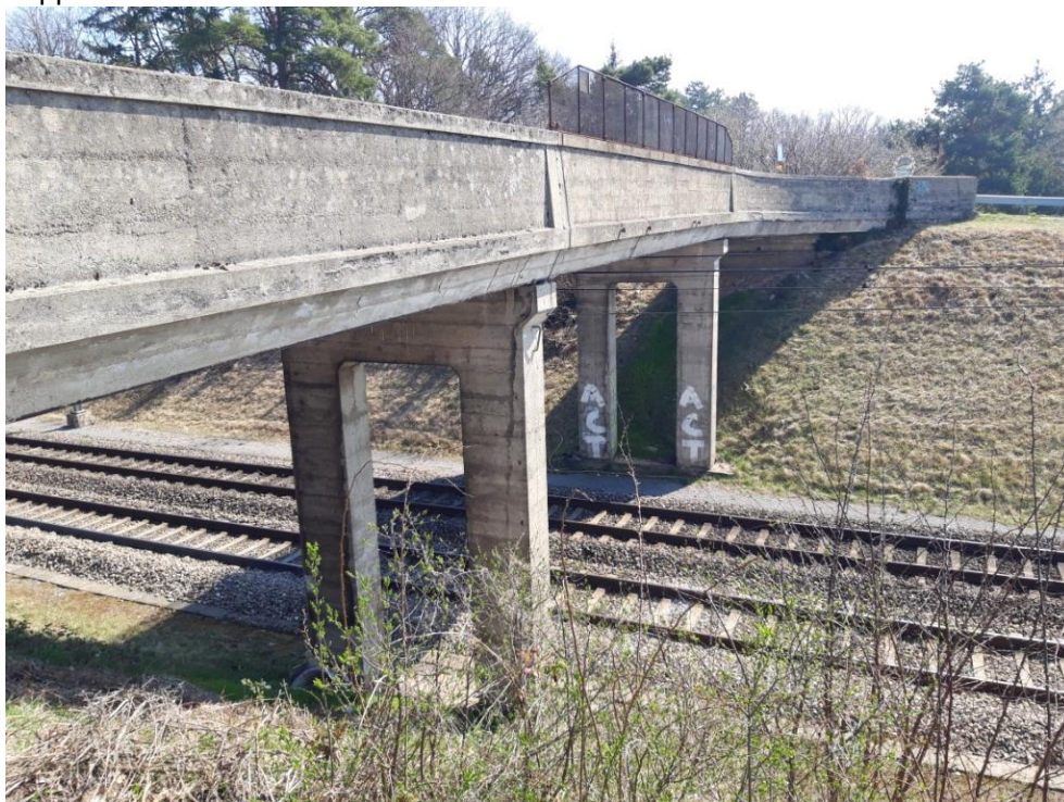
Figure 2 : Pile et culée Nord avec fissures sur les piles
