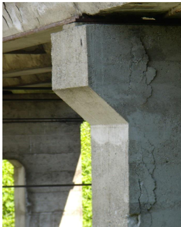
Figure 4 : Pile Nord avec des éclats de béton
