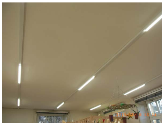
Nouveaux luminaires LED
